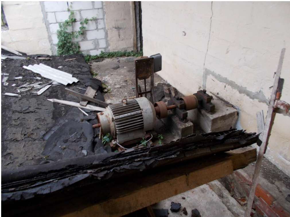
Silnik w budynku gospodarczym do napędu urządzeń w młynie
